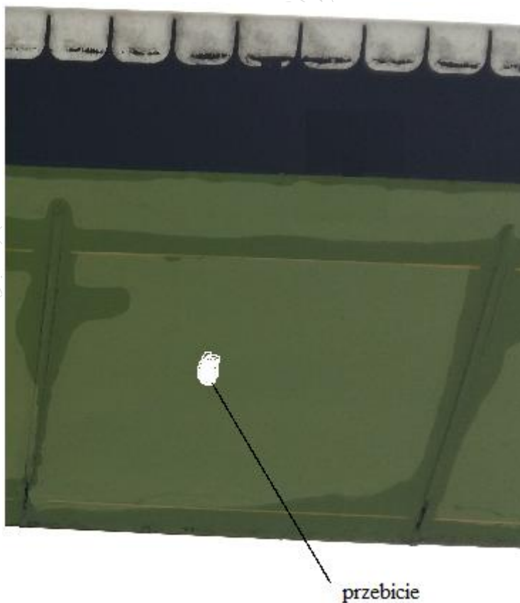
Rys.3 Uszkodzenie (przebicie) sekcji łopaty nr WK 5084953
