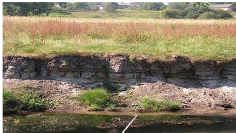
Fotografia 2. Widok wyrwy powstałej w skarpie stwierdzony podczas wizji lokalnej
